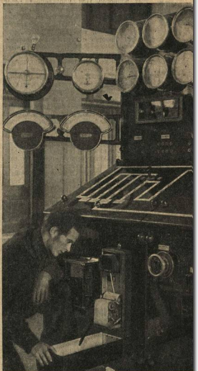
Практикант у пульта управления генераторов Шагурской электростанции.
