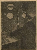
В БЯНСКОМ ОТКРЫТА ЭЛЕКТРОСТАНЦИЯ. - МОНТЕР ВЛЮЧАЕТ ГЛАВНЫЙ ШИТ
