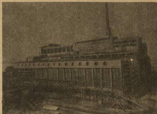
БЕРЕЗНИКИ НОВАЯ ЭЛЕКТРОСТАНЦИЯ
