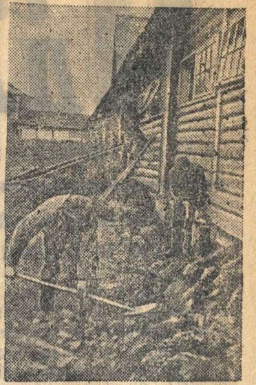
На снимке: Колхозники сельхозартеля «Победа XII Октября» (Пушкинский район, Московская область) ремонтируют и утепляют скотный двор.
