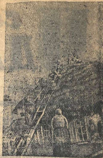
На снимке: Бойцы Н-ской части Ф. Е. Букин и Ф. Я. Якубовский в прифронтовом селе Сталинградской области ремонтируют крышу хаты семьи красноармейца О. И. Степанова.
