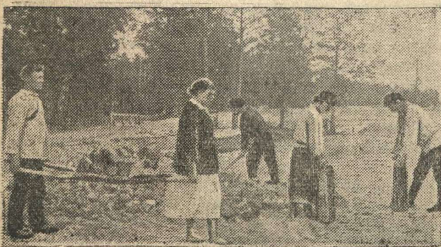
Колхозники Левинской сельхозартели на строительстве народной магистрали Горький—Арзамас—Кулебаки. На снимке: подносят шлак колхозники Н. Мелентьев, П. Ивлева, за трамбовкой полотна С. Сысуев, А. Слыжова, за укладкой шлака А. Сысуев.
