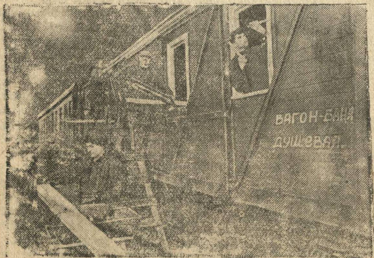
Бригада столяров утепляет вагон-душевую. На переднем плане бригадир Н. И. Осипов (слева) и столяр С. П. Павлов. Фото Л. Доренского. Фотохроника ТАСС.
