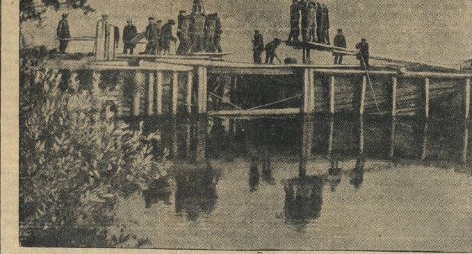
Колхоз имени Коминтерна, Муромского района, строит водную мельницу на протекающей у села Волке Ушма. На снимке: постройка плотины.
