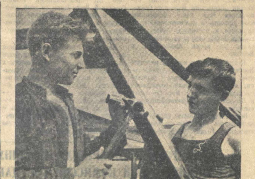
По призыву обкома ВЛКСМ на строительство второй очереди автозавода им. Молотова придут 350 комсомольцев. На снимке: С. Вазуриин и А. Помулов (справа) комсомольцы Пильнинского района, прибывшие на стройку, приступили к работе монтажниками. Фото В. Травинского.
