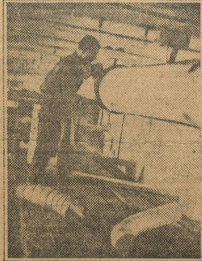
Установка пылесоса в модельном цехе завода «Кр. Сормово».
